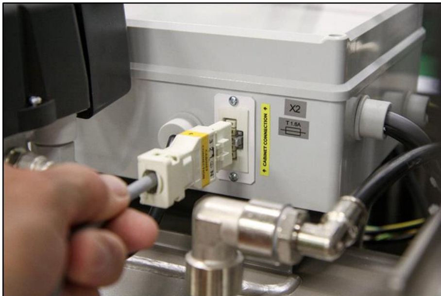
Fig. 13: Raccordement de l'armoire au compresseur
