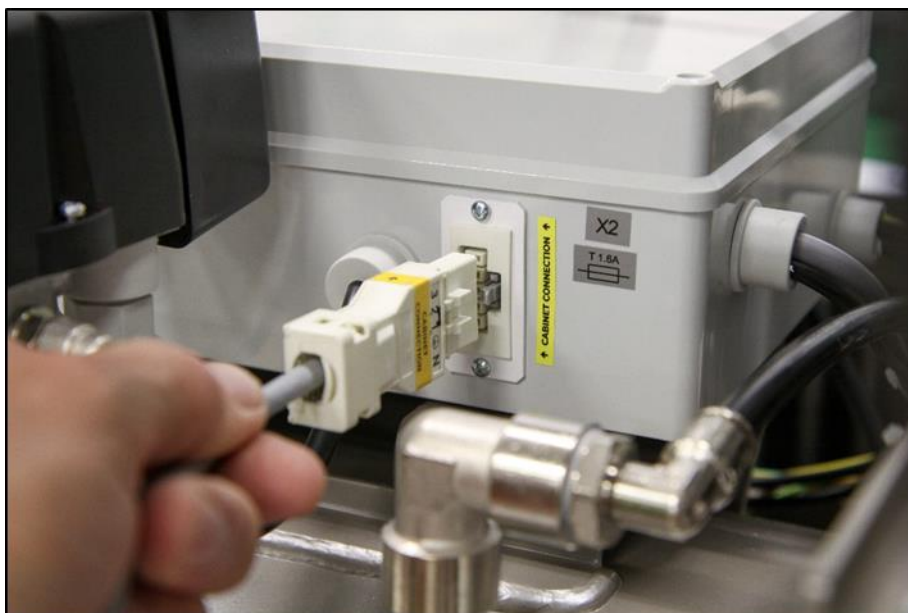
Fig. 13: Raccordement de l'armoire au compresseur
