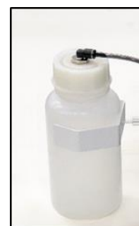
Fig. 16: Vérification de la cuve de collecte de condensats
