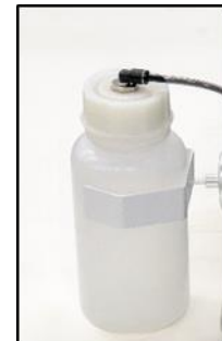
Abb. 16: Überprüfen des Kondensatauffangbehälters
