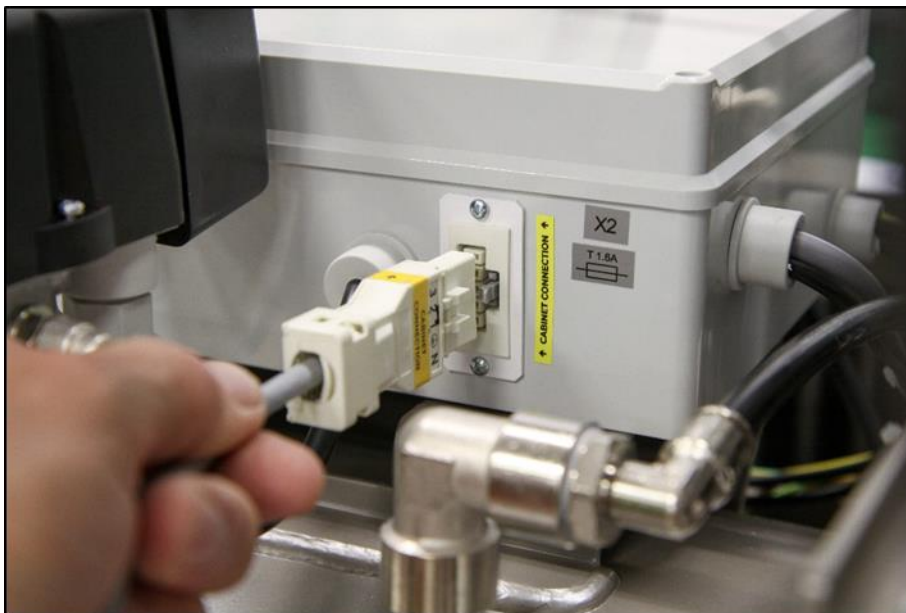
Obr. 13: Zapojenie skrinky ku kompresoru
